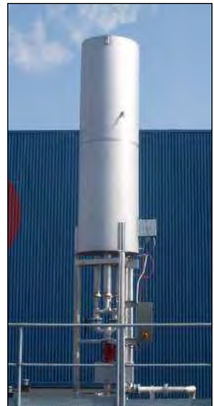
Torchère de sécurité (Source : Clarke Energy)
