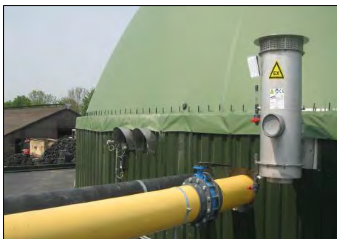
Conduites de gaz et de matières (Source : Biogas Plus)
