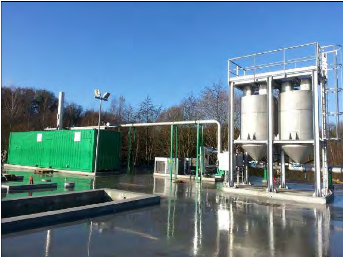
VALOPACK® : traitement par charbon actif (Source : Clarke Energy)
