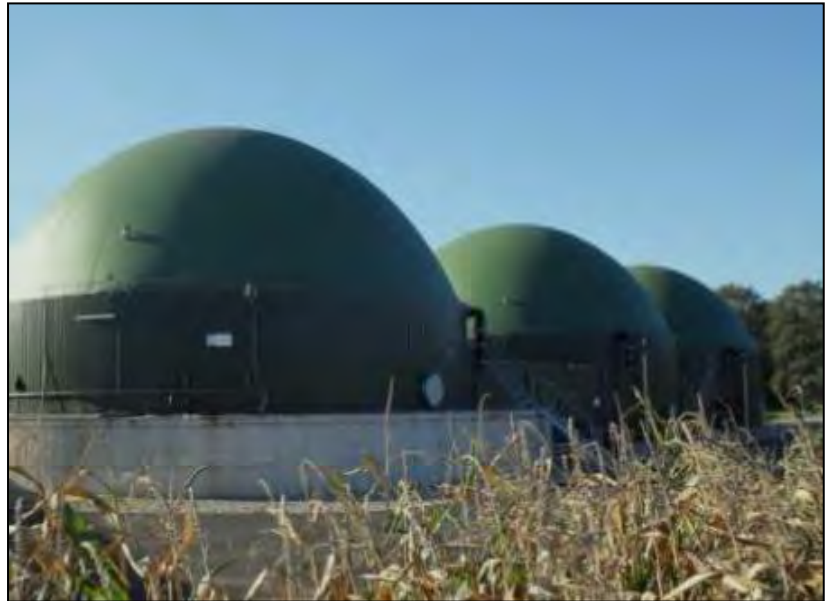
Digesteur entouré de son anneau d'hydrolyse au premier plan et 2 autres digesteurs (Source : Biogas Plus)
