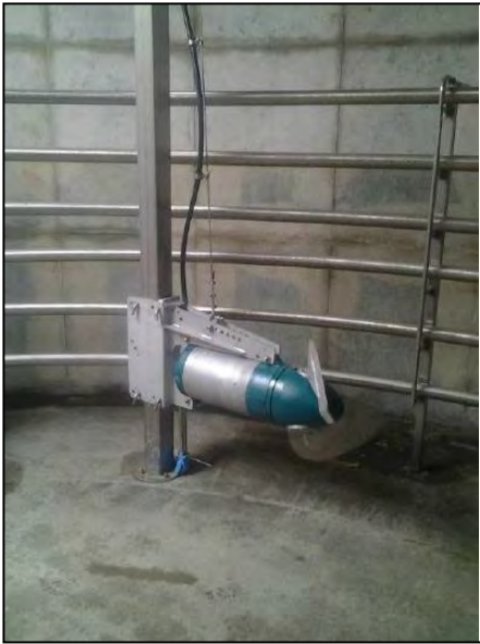
Agitateur et système de chauffage à l'intérieur d'un digesteur (pour ce projet, le chauffage est pris en masse dans le béton) (Source : Biogas Plus)
