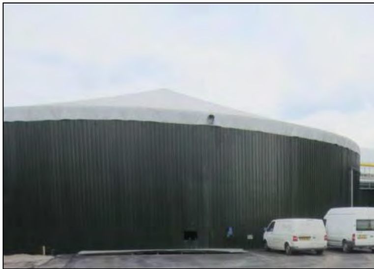
Cuve de stockage du digestat liquide (Source : Biogas Plus)
